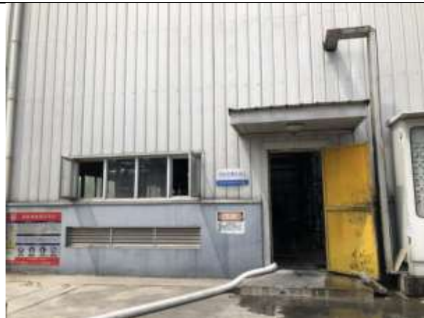
二期生产废水处理设施
